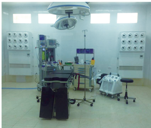
▲写真後方、左右の壁に取り付けられているのが HEPA フィルター。手術室を清潔に保ちます
